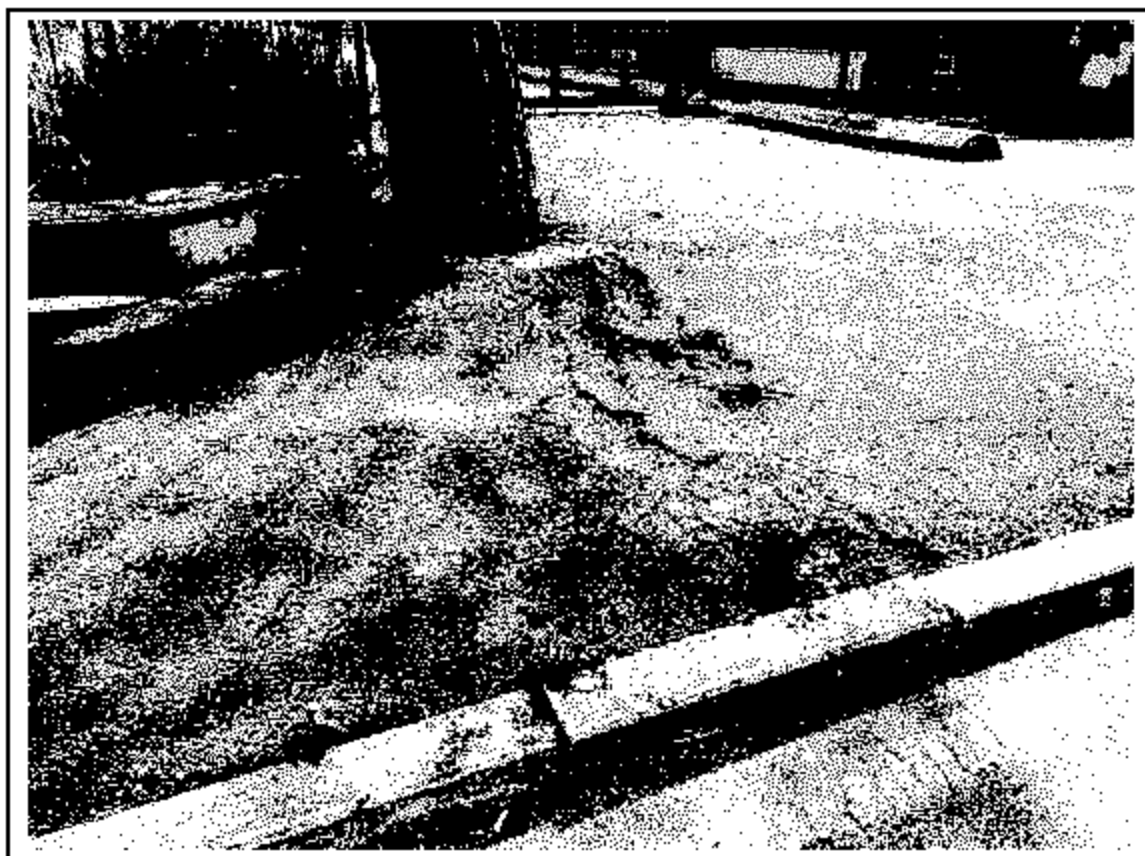
Foto 3 – Esempio 1 – Deformazioni della pavimentazione
