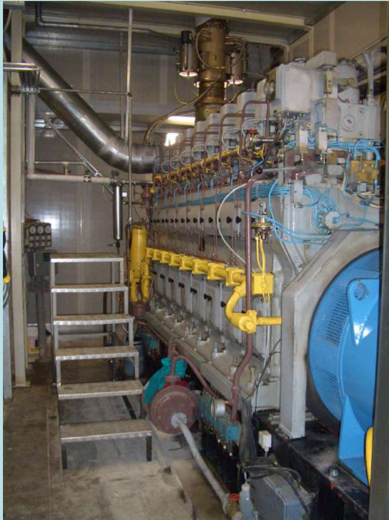
Figura 1. Cogeneratore ad olio vegetale da 1MWe
