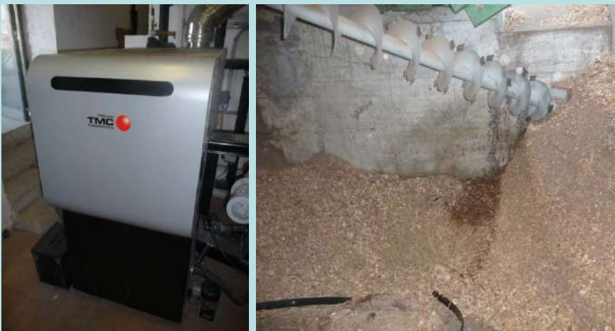
Figura 2. Caldaia a cippato di legna e sistema di stoccaggio ed alimentazione
