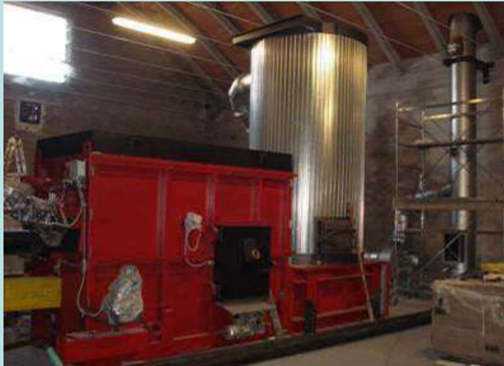
Figura 1. Caldaia a cippato, installata presso Cantine Lungarotti (Torgiano, PG)
