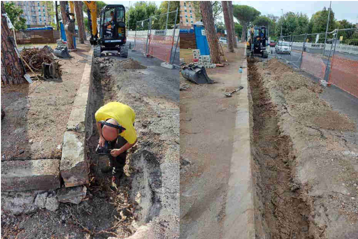
Dopo lo scavo della trincea a lato strada si procede con la potatura radicale e la disinfezione delle sezioni di taglio.
