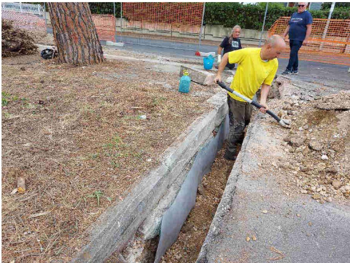
Intervento preliminare manuale di parziale riempimento della trincea allo scopo di favorire la tenuta della struttura della barriera
