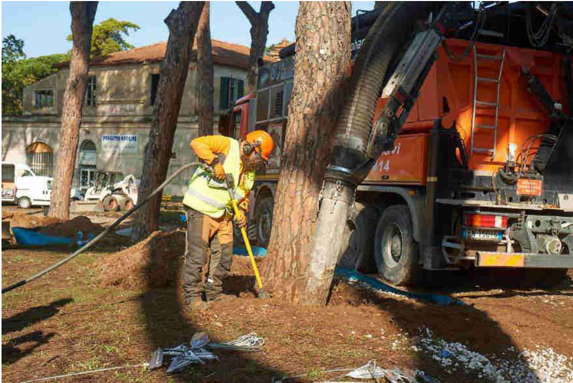
Scavo combinato con escavatore a risucchio Elephant e Air-Spade per l'eliminazione del terreno intorno e tra le radici per evitare il danneggiamento dei sistemi radicali
