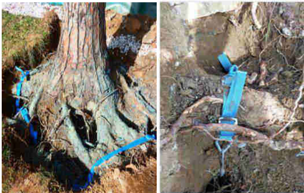
Sistema di ancoraggio inserito su albero di pino domestico al termine dei lavori.
